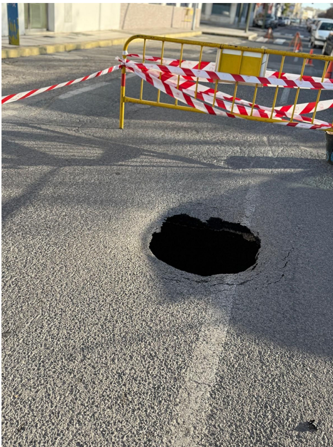
Estado del socavón en la Avenida de las Piletas el pasado sábado.
